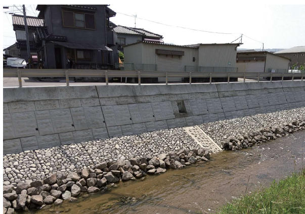
奈良県 米川 ストーンネット樹脂メッシュタイプ
