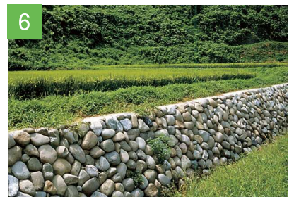
6 天端コンクリートを打設して完成します。コンクリートは最上段の石の頂点より低い位置で打設し、コンクリート面を土で覆う事により自然な仕上がりとなります。
