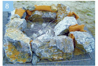
8 削孔した部分に、接着材で専用アンカー部材を取り付けます。
