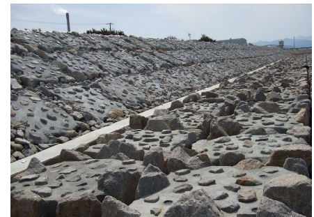
河川での設置例
