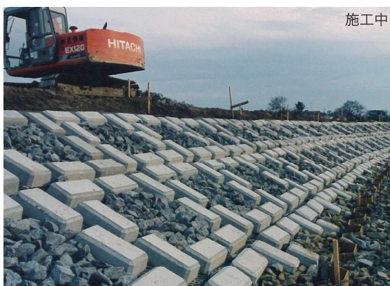
埼玉県 倉松川 コンクリート中詰タイプ150型
