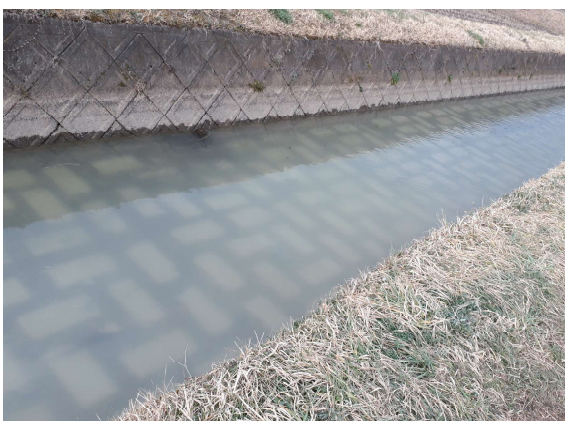
京都府 綾部用水路 コンクリート標準タイプ200型
